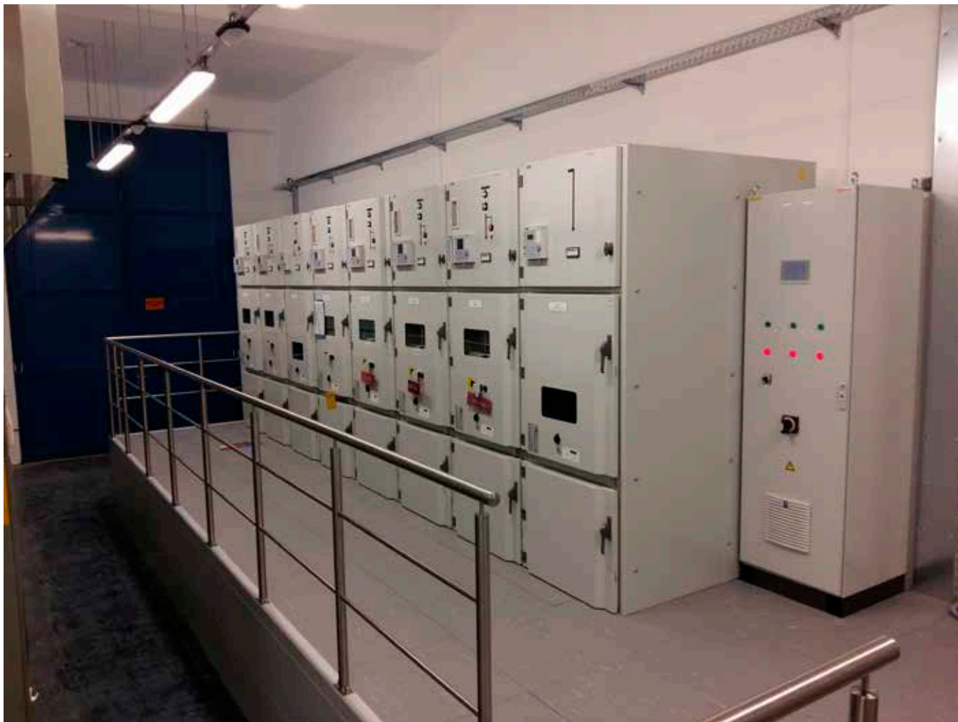
Energetika Ljubljana, enota TOŠ: dobava, montaža, vsa preizkušanja in spuščanje v pogon 20 kV stikališča, dobava in izdelava kompletnega sistema vodenja SN stikališča (SCADA) z vključitvijo v obstoječe sisteme, dobava energetskih transformatorjev
