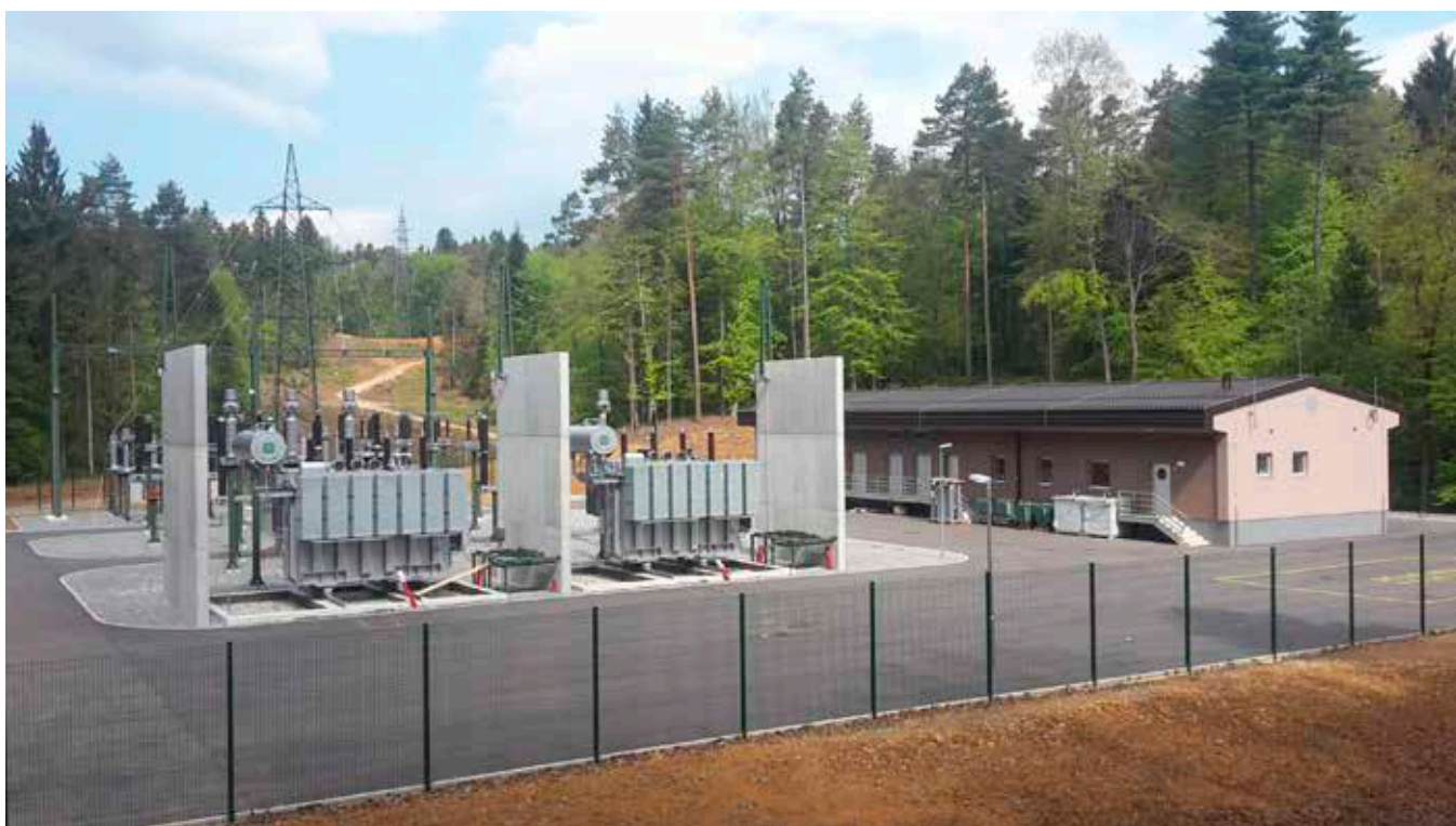
SODO, RTP 110/20 kV Ločna: dobava kompletnega sistema vodenja, zaščite, meritev in kvalitete el. energije za 110 kV del z vsemi preizkušnji (FAT, SAT), dobava in montaža 20 kV celic z vsemi preizkušnji (FAT, SAT)
