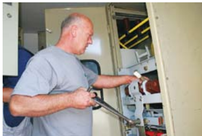
Zaposleni v podjetju Kilovar iz Ljubljane so med 7. in 8. avgustom opravili redni letni preventivni pregled vseh šestih transformatorskih postaj. Postaje so dobro očistili, opravili vse meritve, preizkusili stikala in opravili kontrolo transformatorskega olja. Za pregled ene transformatorske postaje so potrebovali od dve do štiri ure, odvisno od velikosti in napak
